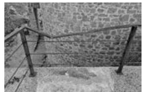
Daños en el interior de la Torre del Homenaje. Fotografía Fernando Sánchez López.
