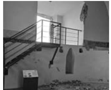
Daños en el interior de la Torre del Homenaje. Fotografía Fernando Sánchez López.
